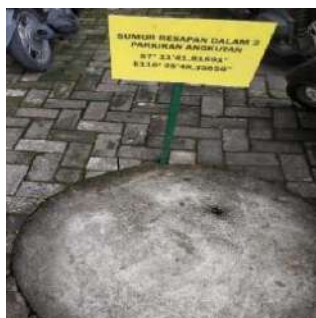
Sumur Resapan Dalam Lokasi Parkiran
