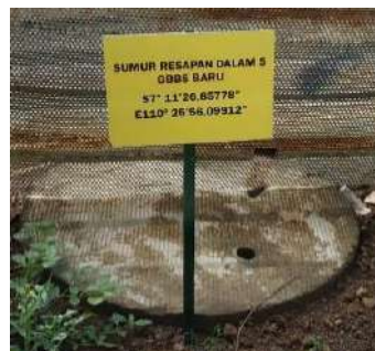
Sumur Resapan Dalam Lokasi Gd. B.Baku
